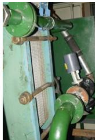
图6 高温循环部分管路
