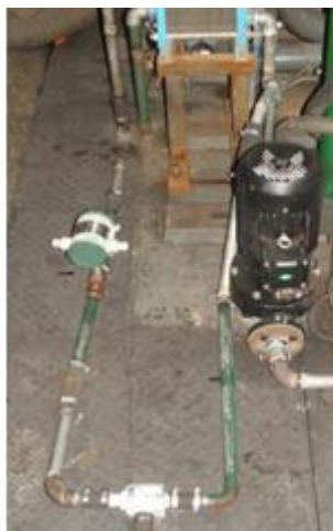
图5 低温循环部分管路
