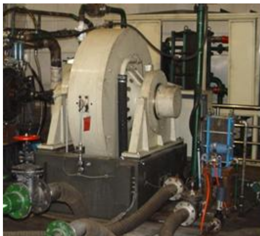
图4 柴油机及冷却系统试验台架
